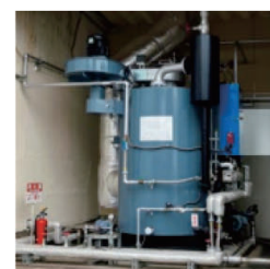
東北工場に導入した 廃食油ボイラー
