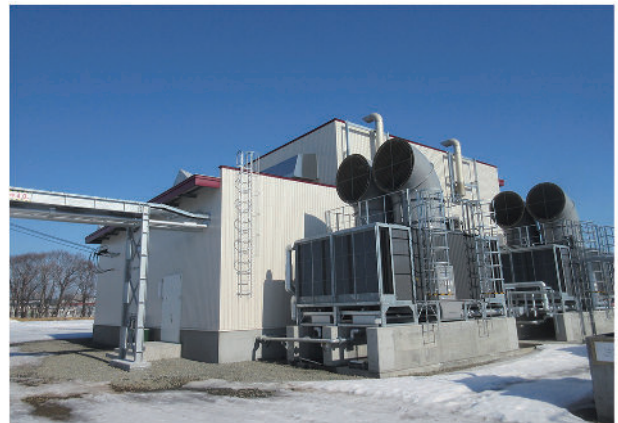
コージェネレーション設備
