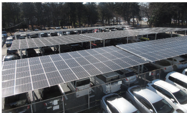
カーポート方式の太陽光発電設備
