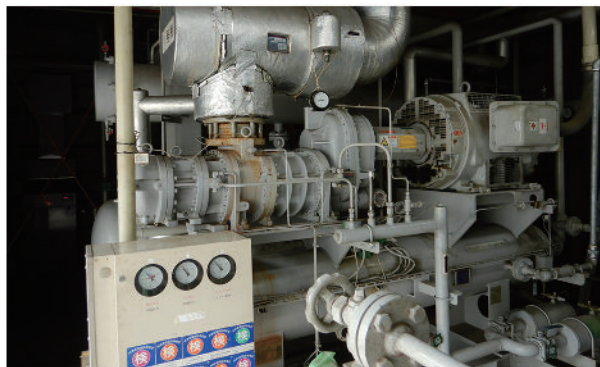
フリーザ用大型冷凍機
