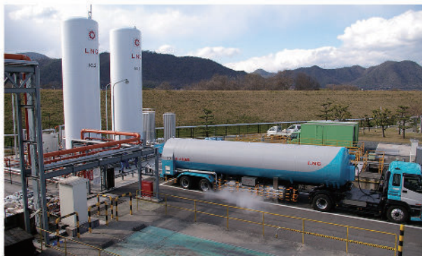
LNGサテライト設備
