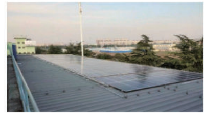
太陽光発電電力の利用を開始した (中国)不二製油(張家港)有限公司
