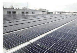
宇都宮工場 太陽光パネル
