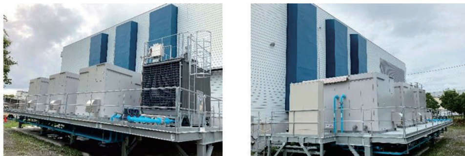
ノンフロン冷凍機
