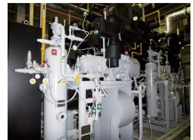
ノンフロン冷凍機
