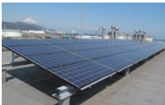
富士山パスタプラントの屋上に設置した太陽光発電パネル
