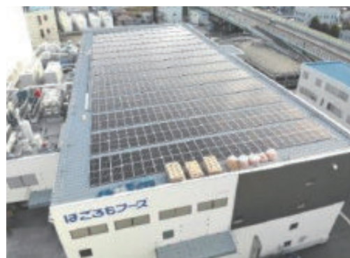
新清水プラントの屋上設置した太陽光発電システムが2022年12月より稼働。プラントの消費電力の15%を自家発電。
