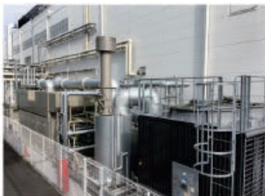
神戸工場コージェネレーションシステム
