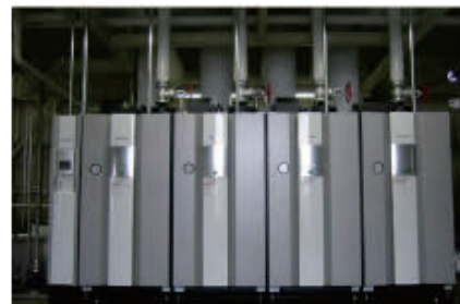
液化天然ガスに燃料転換したボイラー
