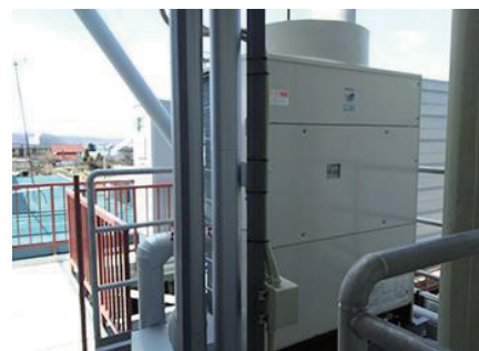
(株)明治長野チーズ工場の冷凍機
