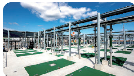
活性汚泥の分離に膜を使用するMBR（膜分離活性汚泥法）の設備
