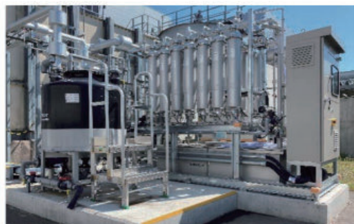
ろ過器逆洗水回収設備(海老名工場)
