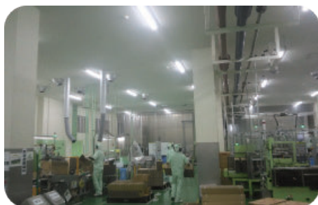
工場内照明のLED化
