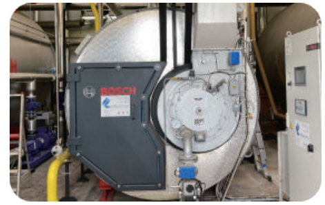
高効率のボイラーへの更新
