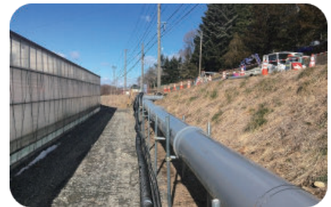
工場の排CO 2 を菜園に送る配管
