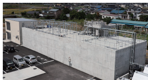
伊勢崎工場 排水処理設備
