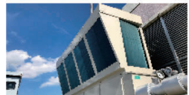
新冷媒を採用した機器を導入（草加工場）
