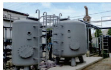
中水設備（草加工場）
