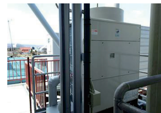
(株)明治長野チーズ工場の冷凍機 明治ホールディングスHPより
